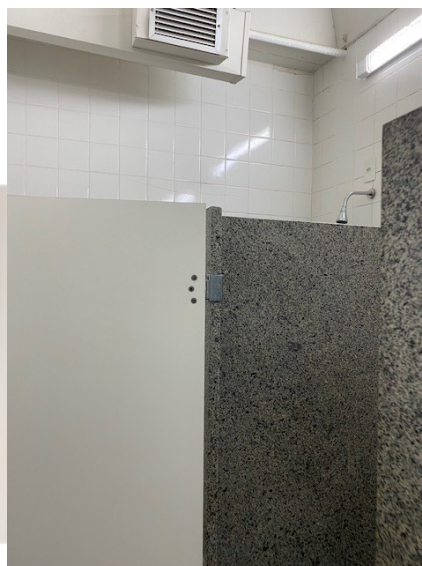
Figura 37 – Único chuveiro banheiro feminino UIG;
