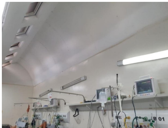
Figura 17 – Leitos sala vermelha- medicações feita sem Bombas de Infusão;
