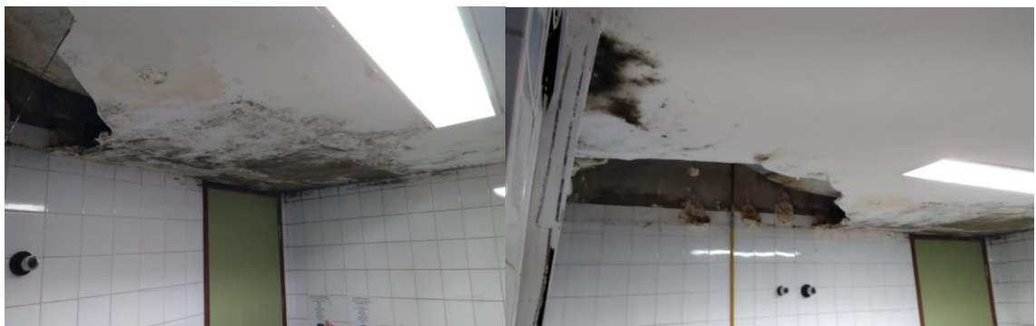
Figura 53 – Teto da UTI geral do hospital com mofo e infiltração
